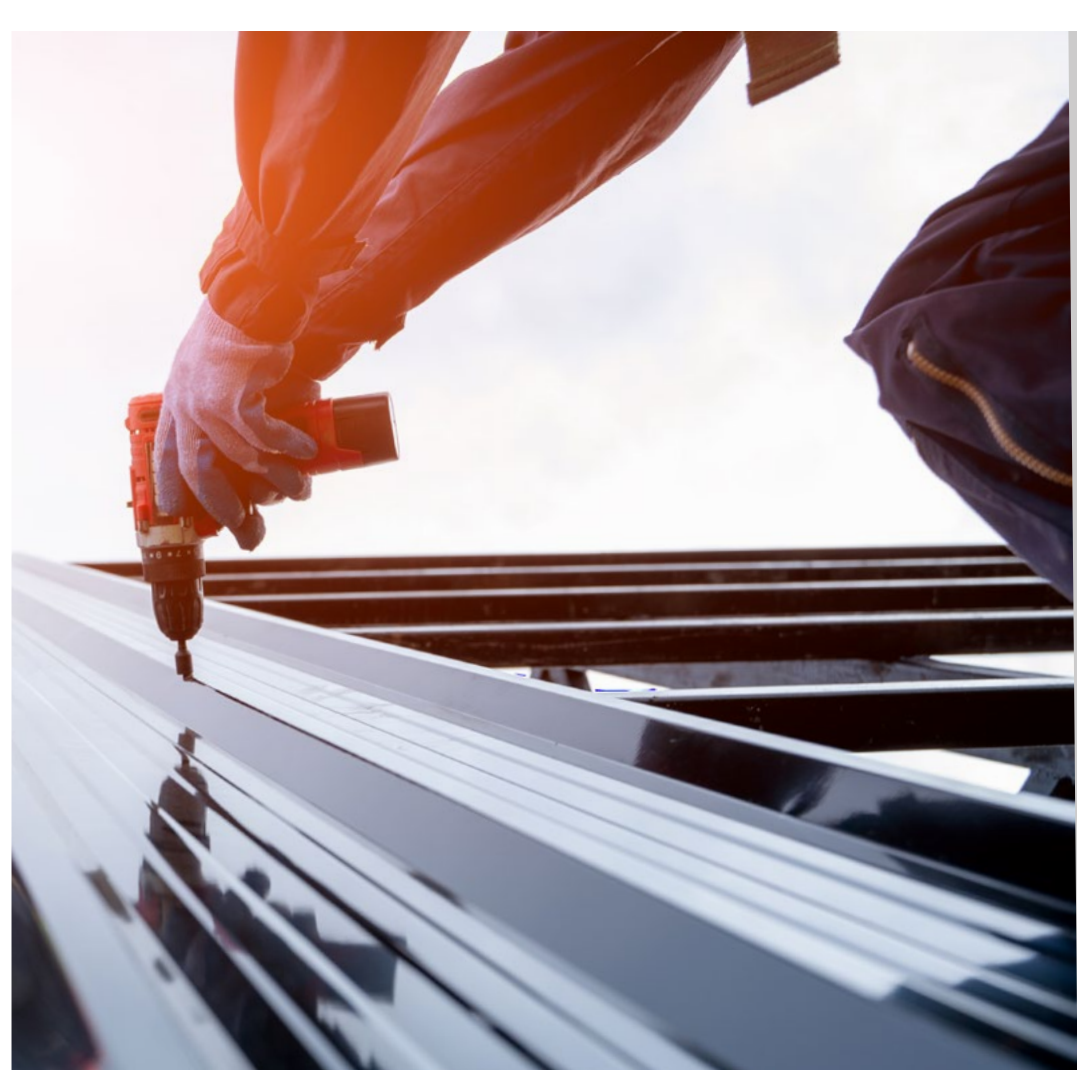
Revisão e reposição da vedação da caixilharia e das janelas da fachada
