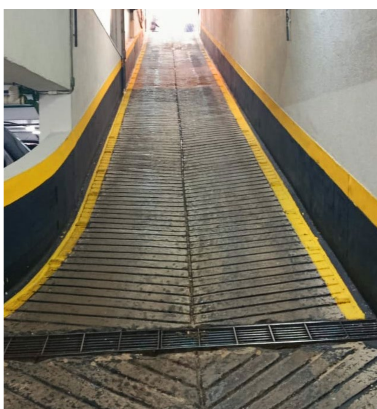
Pintura das paredes laterais e do pergolado das rampas de acesso à garagem
